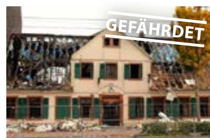
Altes Relaishaus bzw. Kießler-Hof, Mannheim-Rheinau (BW): Brand durch Brandstiftung des Eigentümers im Oktober 2015, 1768–71, Baustil: zeittypisch, Besonderheit: eines der ältesten Häuser von Mannheim-Rheinau, Verfall seit Brand, notgesichert, immer noch im Besitz des Brandstifters
