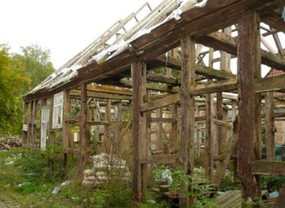
Ein angeblich einsturzgefährdeter Schornstein wurde als Ursache für die ungenehmigte Abtragung nahezu des gesamten Gebäudes bis auf das Holzskelett angeführt
