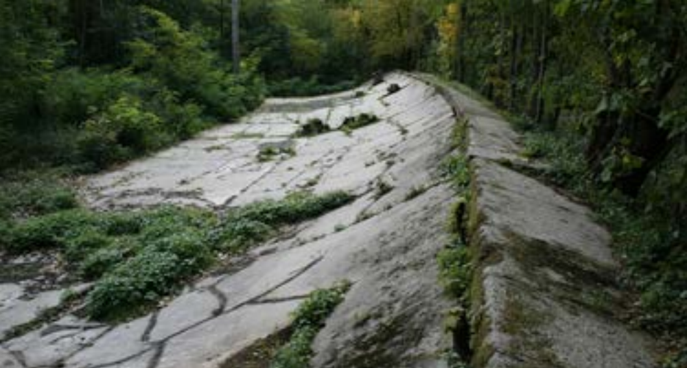
Die denkmalgeschützte Rennstrecke ist in einem beklagenswerten Zustand
