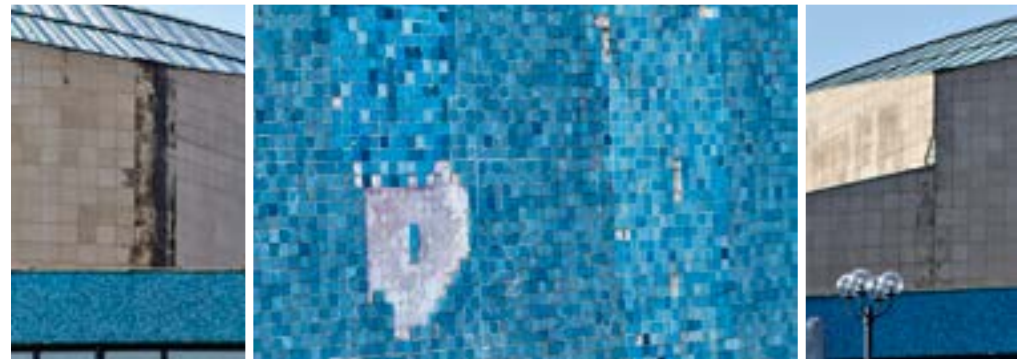
Im Laufe der Jahre war die Halle sanierungsbedürftig geworden
